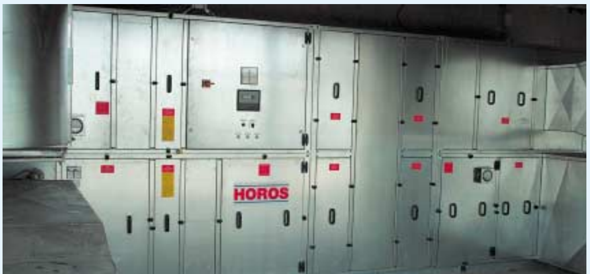
Figuur 4. Opstelling van de luchtbehandeling in de technische ruimte.
