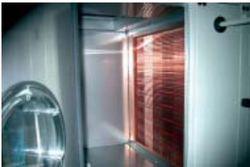
1. Twincoil koeler, in koper uitgevoerd, in de luchtafvoer van een luchtbehandelingskast.
