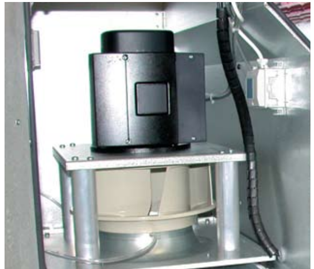
Detail van de ventilator
