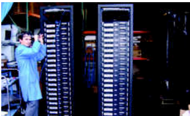
Afbeelding 2: computer racks in magazijn
