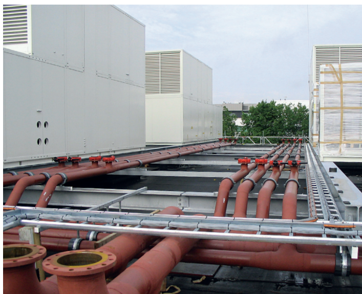
1. Luchtbehandelingskasten en gekoeldwaterleidingen op het dak van Getronics PinkRoccade in Amsterdam.
