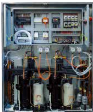
De technische ruimte is zeer toegankelijk voor inspecties en onderhoud van onderdelen.
